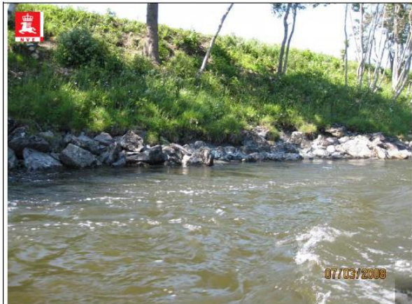
Midtre deler av anlegg som er skadet.
