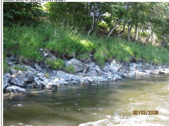
Nedre deler av anlegg som er skadet.
